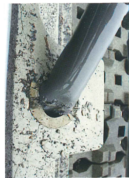
1本目のひび割れ状況
