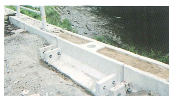
⑥ 製品を設置した状況
