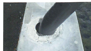
縦断方から見た支柱の変位状況
