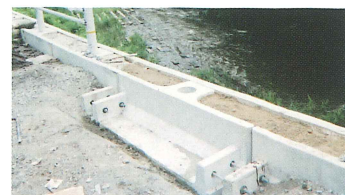
⑥製品を設置した状況
