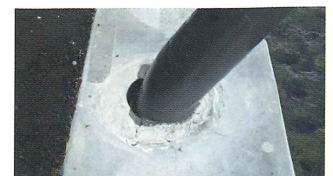
縦断方から見た支柱の変位状況
