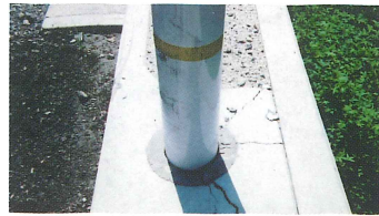
②埋め込み部分のひび割れの状況
