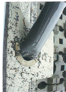
1本目のひび割れ状況
